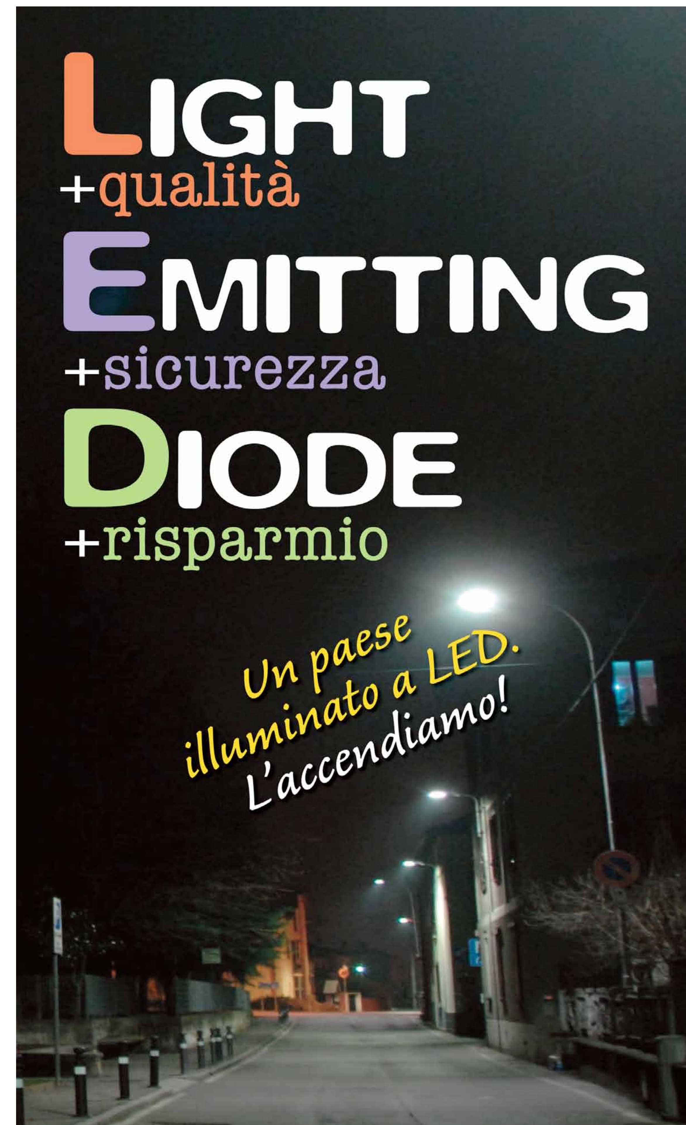
A SINISTRA VIA MARTIRI DELLA LIBERTA' ZONA CIMITERO AD INTERVENTO REALIZZATO Corpo illuminante a Tecnologia Led modello AEC LED con 54 LED (68W)
