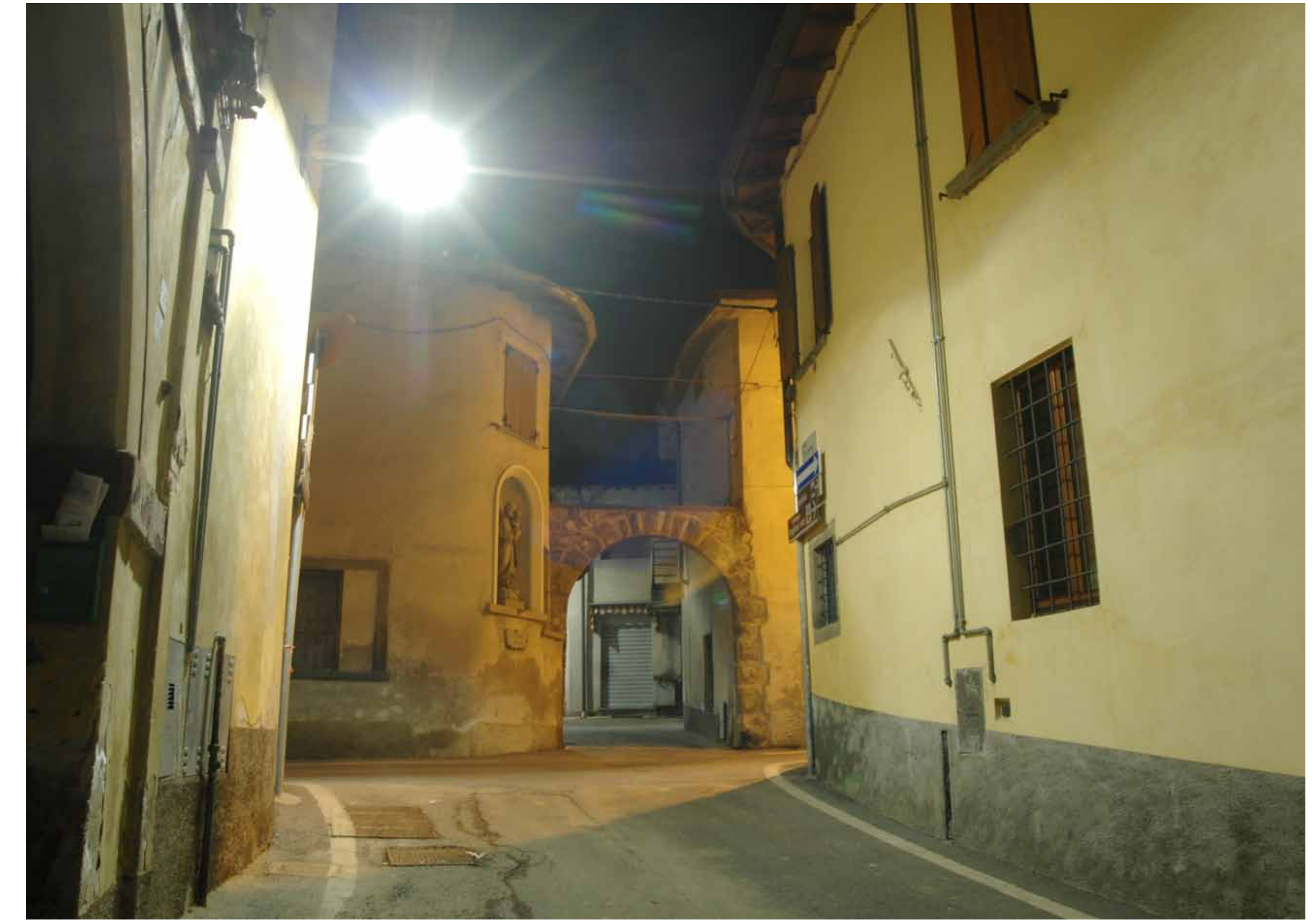
SOPRA INTERSEZIONE TRA VIA ROMA E PIAZZA BARTOLOMEO COLLEONI AD INTERVENTO REALIZZATO Corpo illuminante a Tecnologia Led modello Neri SN 104 con 40 LED (50W)
