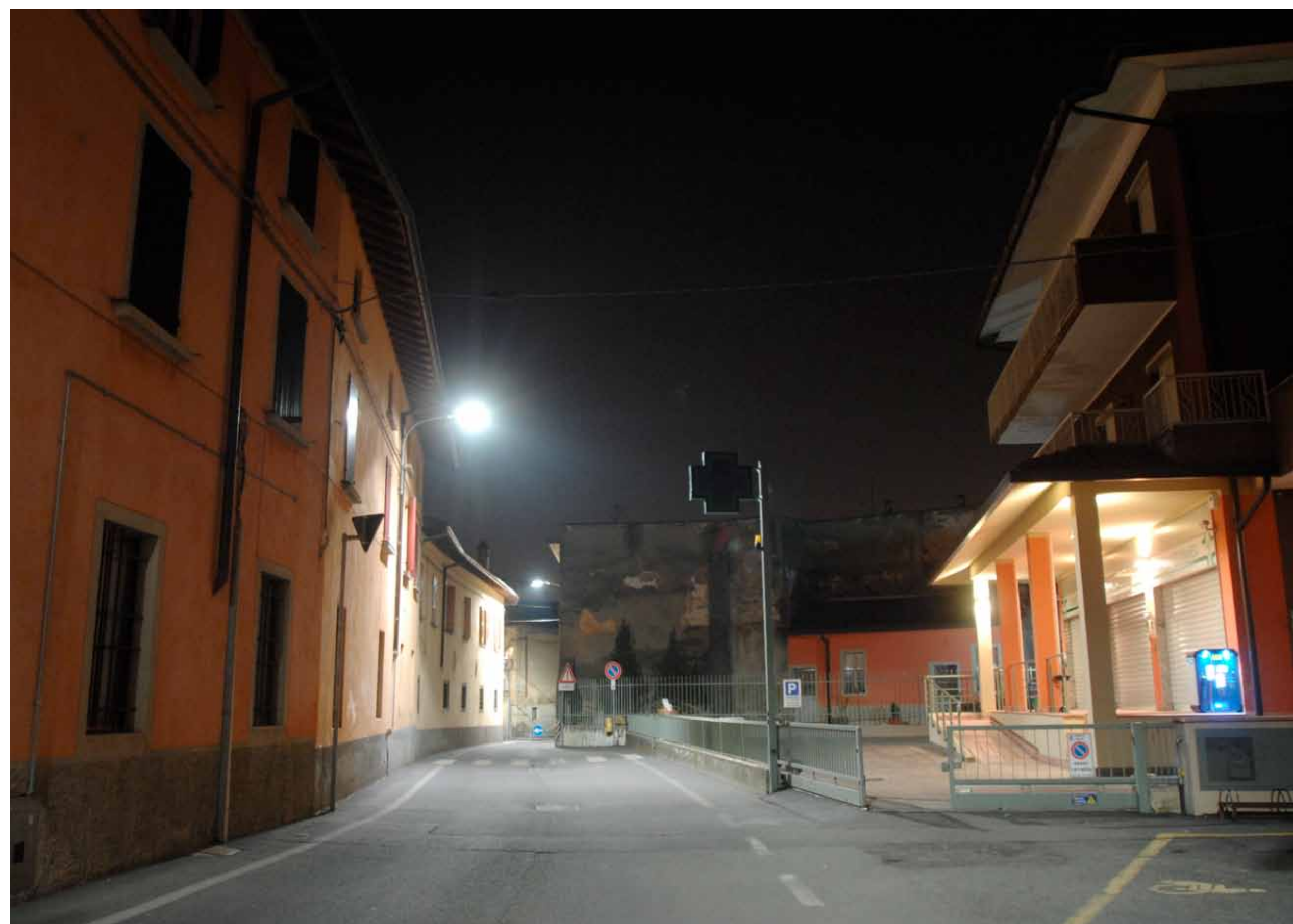
SOTTO VIA ROMA ZONA FARMACIA COMUNALE AD INTERVENTO REALIZZATO Corpo illuminante a Tecnologia Led modello AEC LED con 54 LED (68W)
