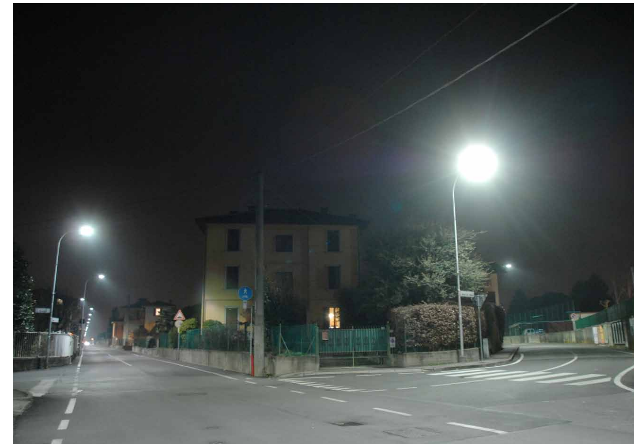
SOTTO INTERSEZIONE TRA VIA ROMA E VIA DON GIACINTO BANI AD INTERVENTO REALIZZATO Corpo illuminante a Tecnologia Led modello AEC LED con 54 LED (68W)
